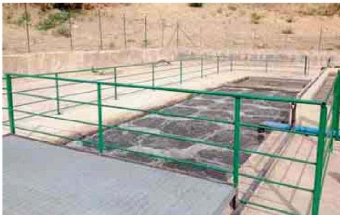
Qui sopra un particolare del depuratore di Pergusa
